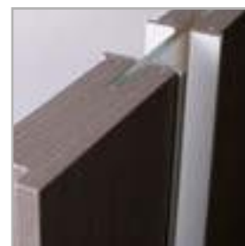
górną krawędź skrzydła bez przyłgi
